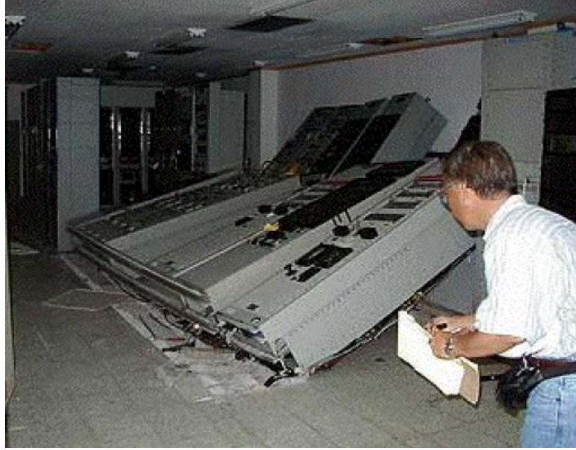
الشكل (5) سقوط بعض اللوحات الكهربائية في صالة القيادة والتحكم.
