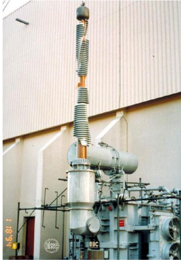
الشكل (2) تحطم البورسلان في محول (400/220kV)
