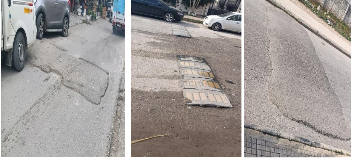
الشكل (12) التآكل في بعض المطبات المستخدمة.
